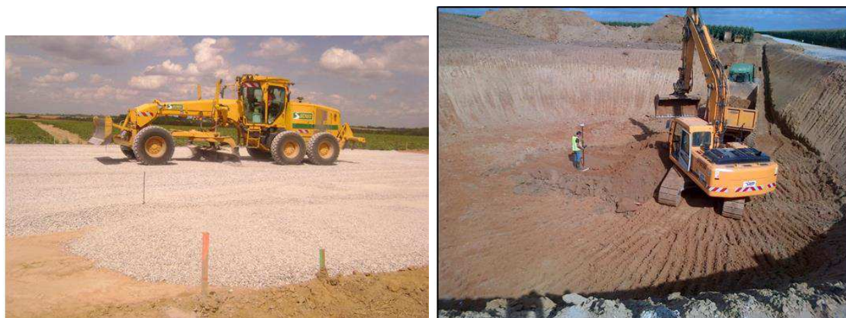
Photographie 1 et Photographie 2 : Réalisation des fouilles du chantier du parc éolien de Caix
